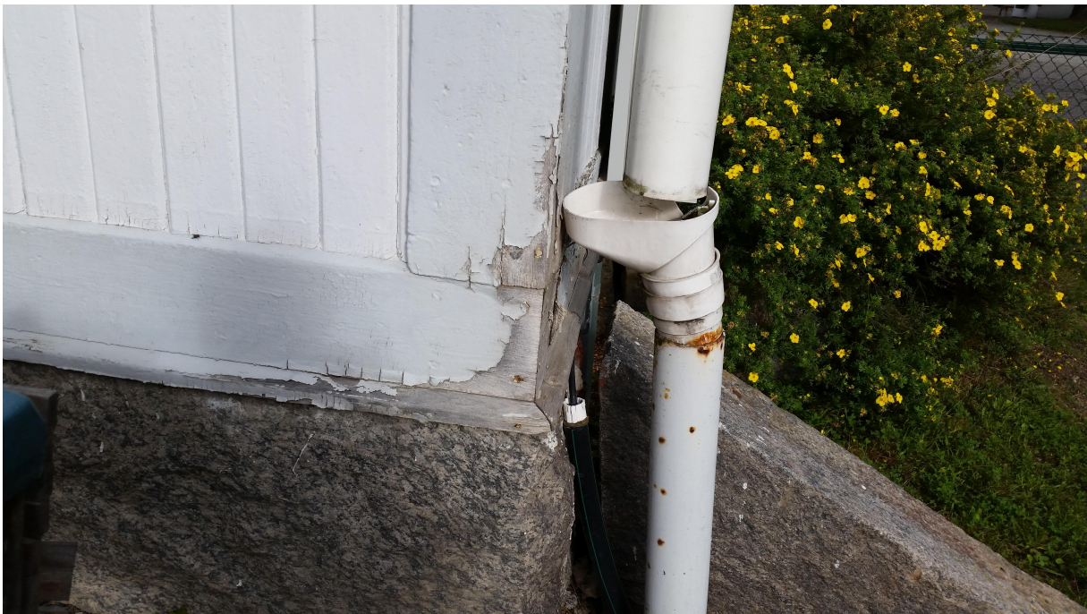
Stuprännor är felmonterade så att vatten rinner mot vägg och grund.
