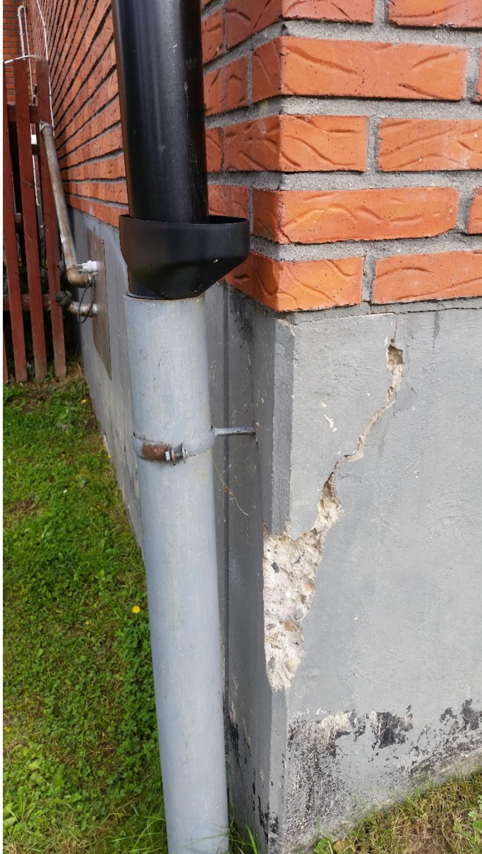
Stora sprickor i grunden i den nyare skolbyggnaden, röda huset.
